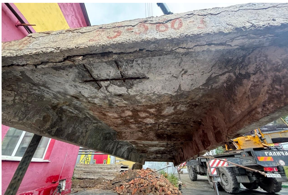
Рисунок 1- Фотофиксация состояния неработоспособных плит покрытия
